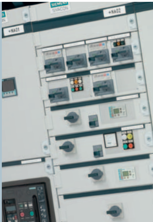
Cuadro de baja tensión SIVACON: con capacidad de comunicación, económico, muy flexible y, sobre todo, ¡fiable!
