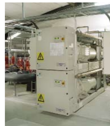
EQUIPAMIENTO PRINCIPAL: 4 x EUWS100KX
