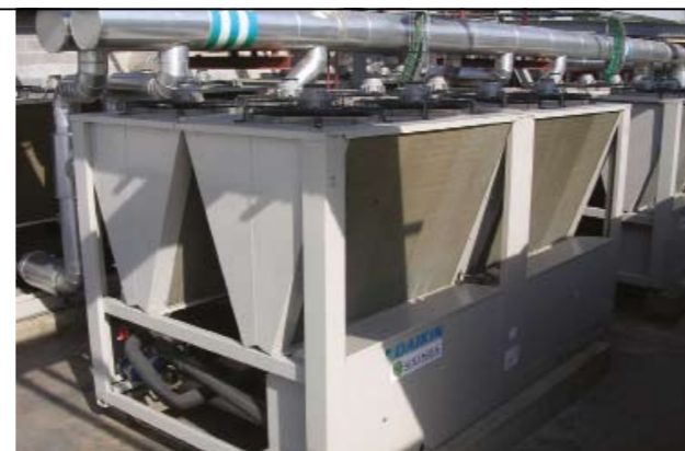
EQUIPAMIENTO PRINCIPAL: 24 x EUWA120KBX
