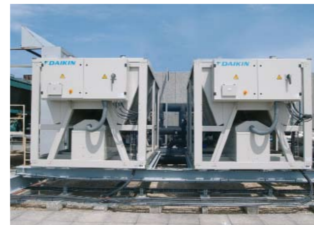
EQUIPAMIENTO PRINCIPAL: 3 x EUWA120MZY 1 x unidad de control DICN
