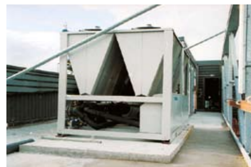
EQUIPAMIENTO PRINCIPAL: 1 x EUWA120KBXY
