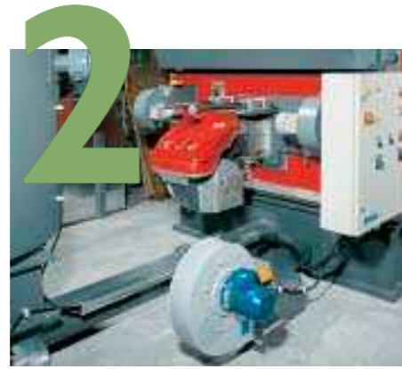
Dispositivo de protección y habilitación para quemador de gasóleo y/o gas.
