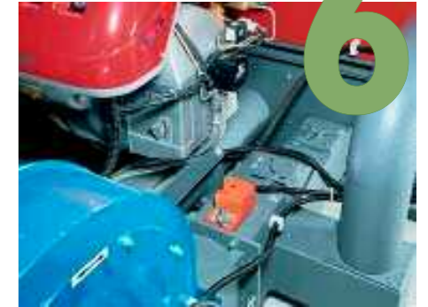
Colector de encauzamiento del aire de combustión primario y secundario con registros manuales de regulación y registro automático de cierre total.
