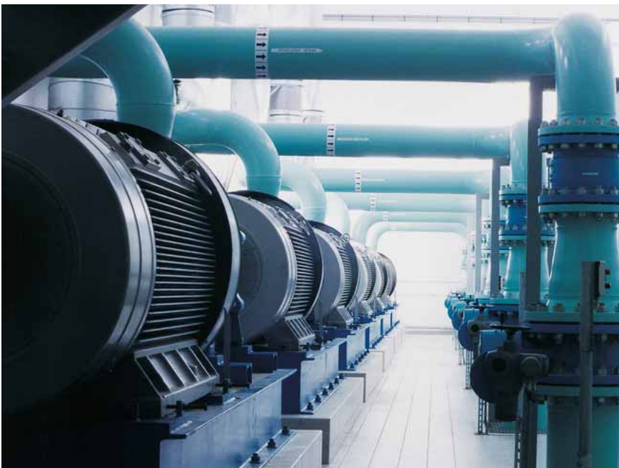
Estación de bombeo
