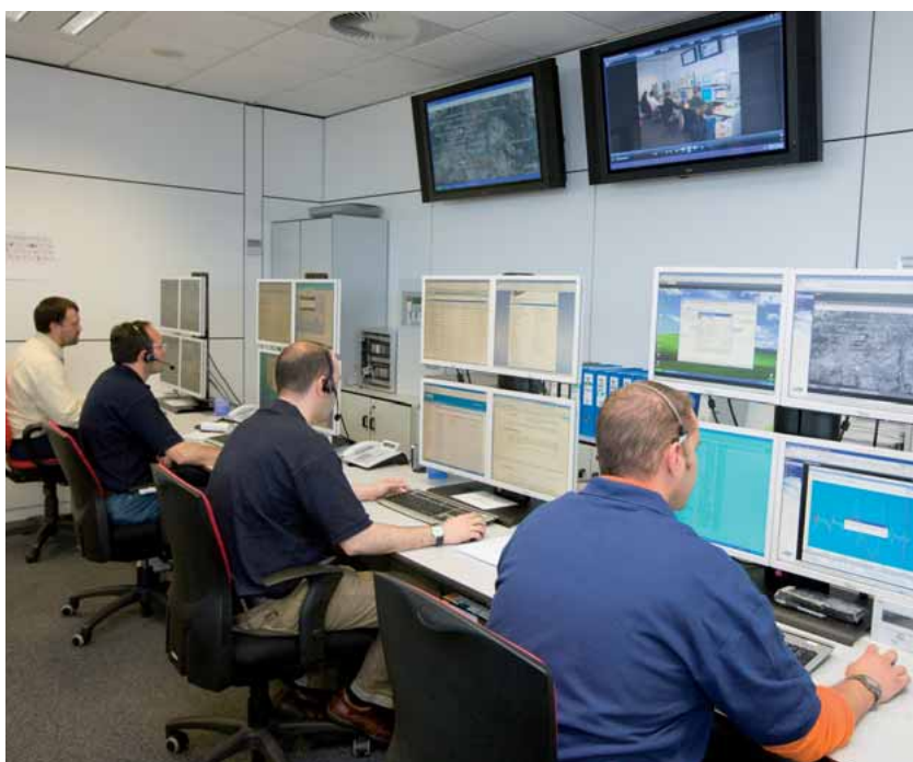
Centro de Operaciones Remotas en Siemens Tres Cantos
