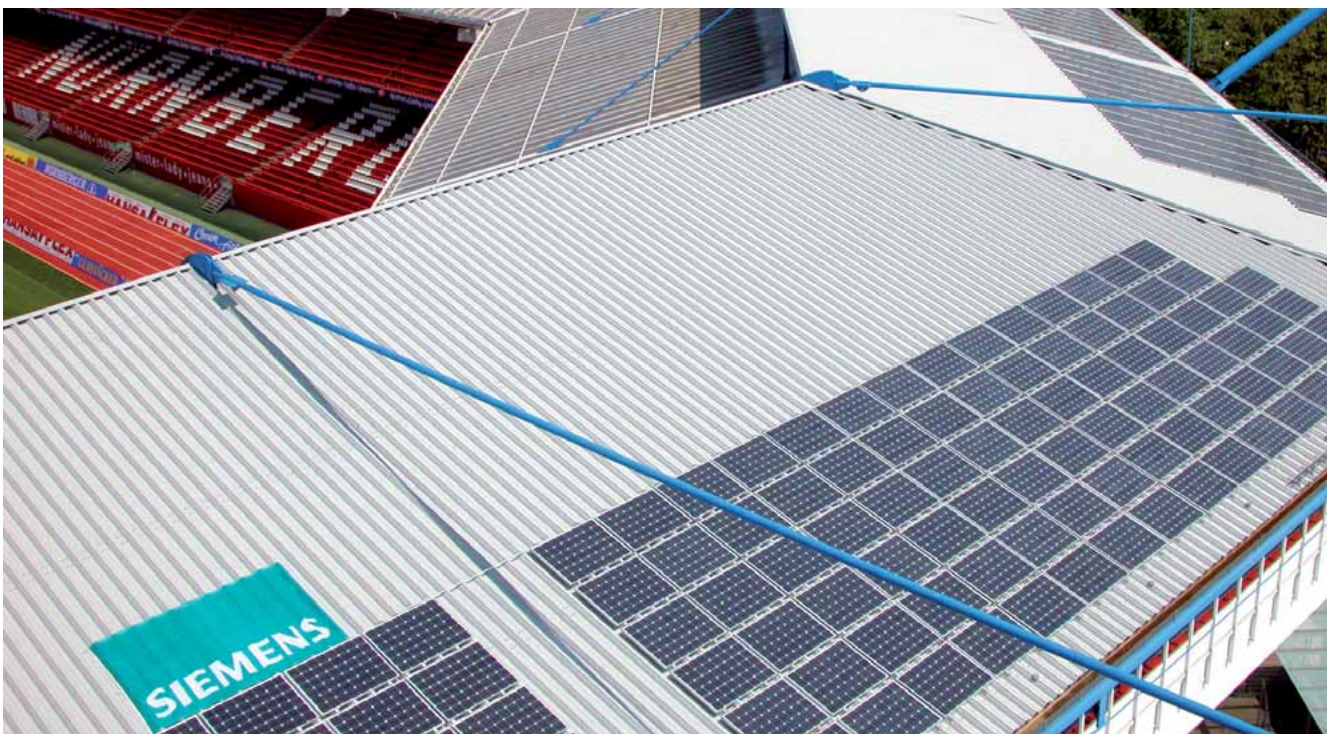
Paneles solares sobre el tejado del estadio de fútbol de Nüremberg (Alemania)
